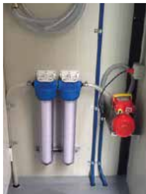
POMPA PER FILTRAZIONE ACQUE
